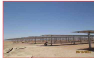
Módulos fotovoltaicos instalados
